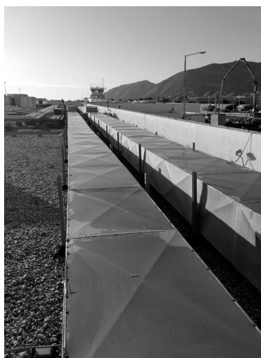
DELTA DUCT DERMITZAKIS Αεροδρόμιο Σαντορίνης
