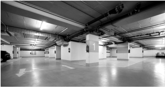
DELTA DUCT DERMITZAKIS Σταθμός αυ/των, Κολωνάκι
