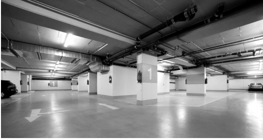
DELTA DUCT DERMITZAKIS Σταθμός αυ/των, Κολωνάκι
